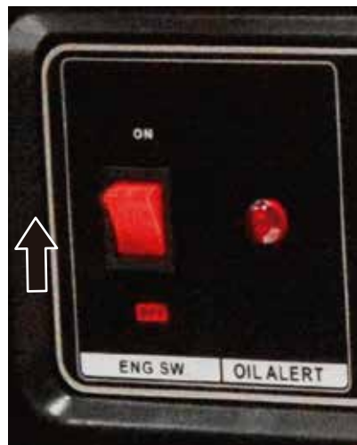
Figura 19 – Interruptor de control del motor
